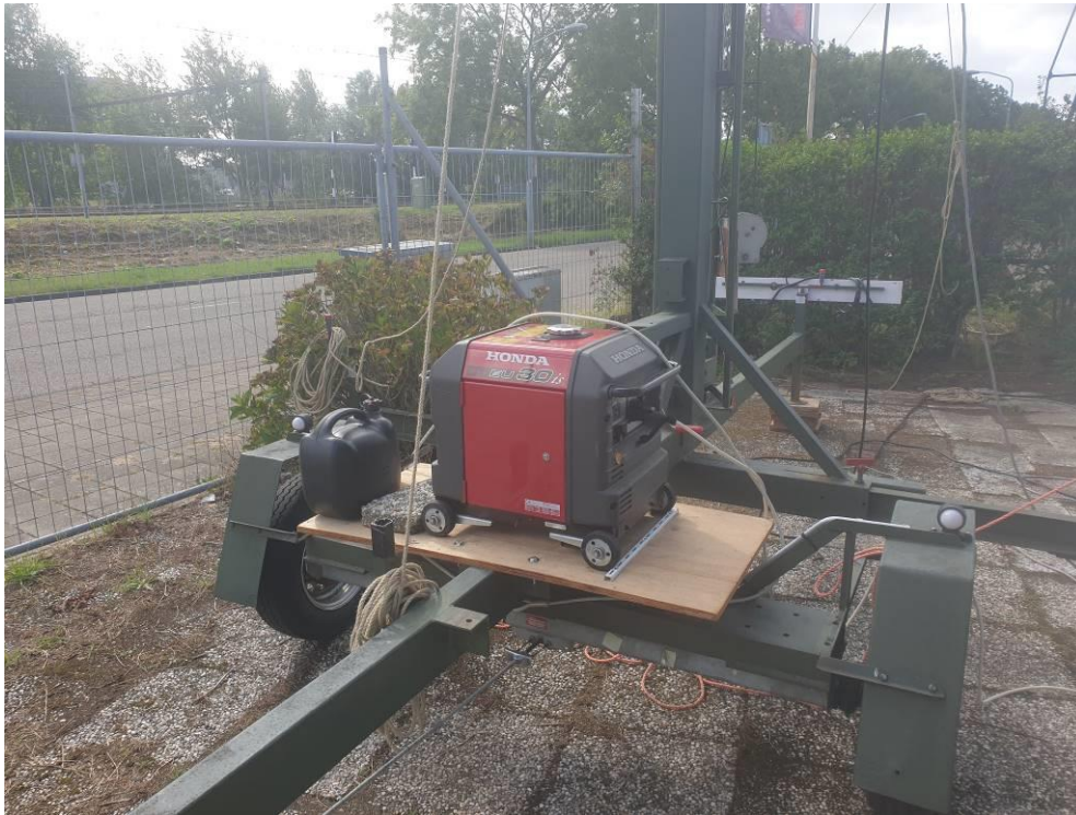
Het huidige aggregaat wat wij in bruikleen hebben kan ook op de mobiele mast worden gemonteerd.
