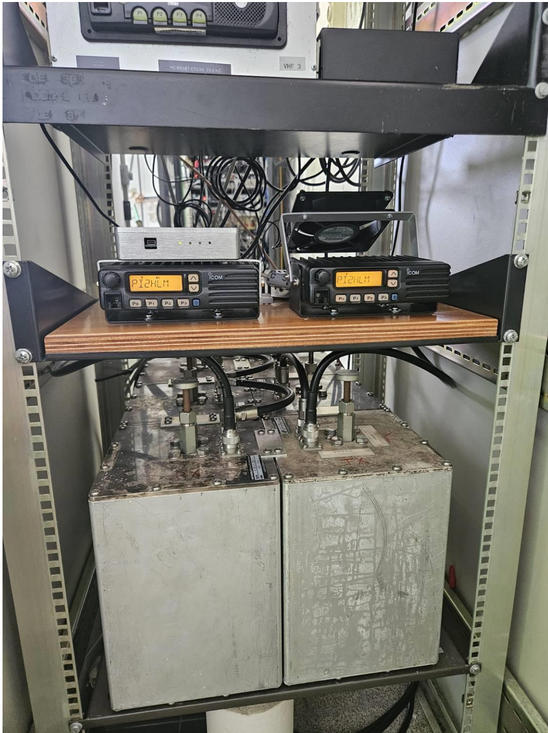
De 19-Inch kast waarin o.a. PI2HLM staat na het omdraaien van de Cavity en de reorganisatie van het kabelwerk.
