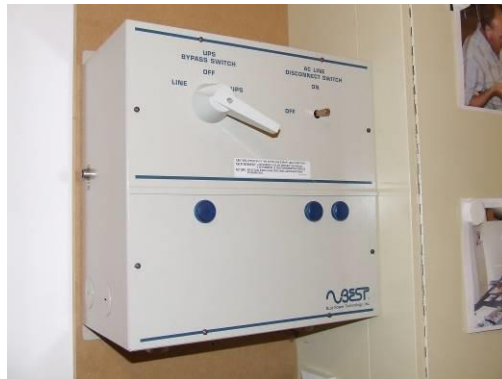
De schakelkast in het NVRA gebouw
